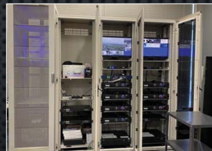
サーバー室 システムラック
